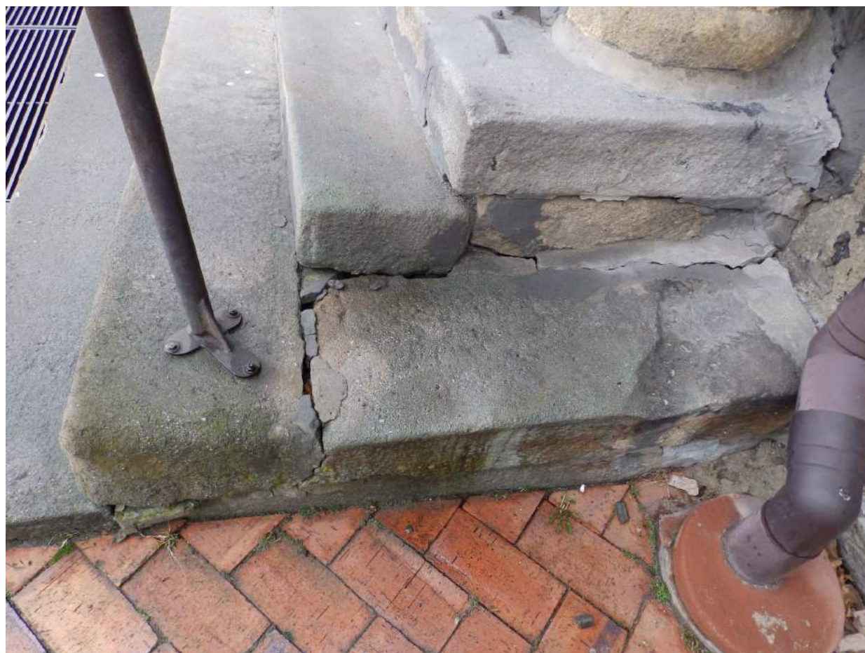
Fot.15,16 Widoczne pęknięcia i uzupełnienia zaprawą cementową
