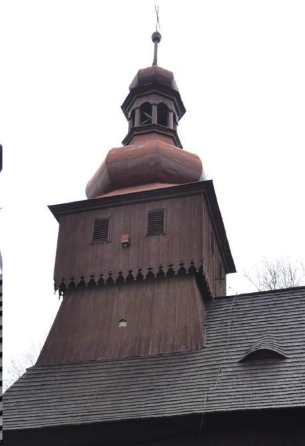
Fot.9 Zniszczone pokrycie hełmu wież
