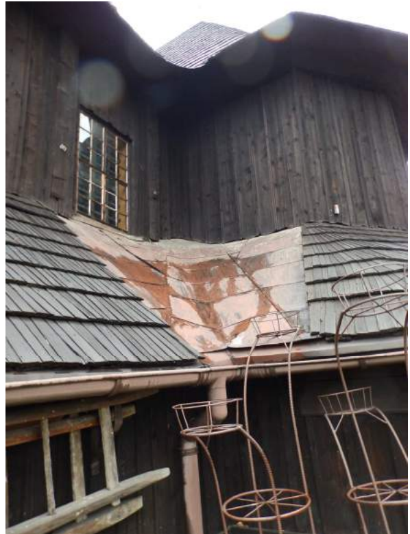
Fot. 2 – Stan obróbek blacharskich kosza nad sobotami
