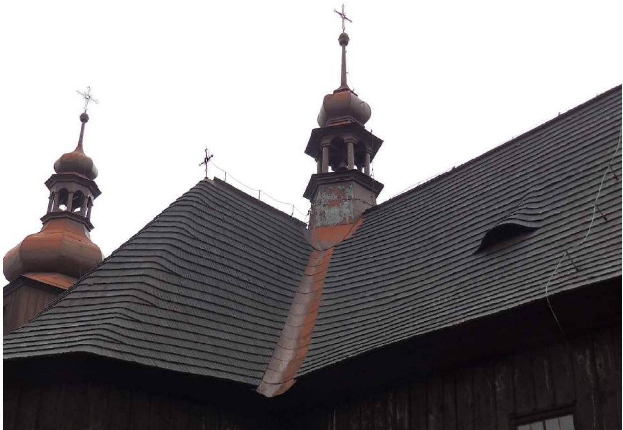
Fot.6 – Zniszczone opłaszczowanie sygnatury
