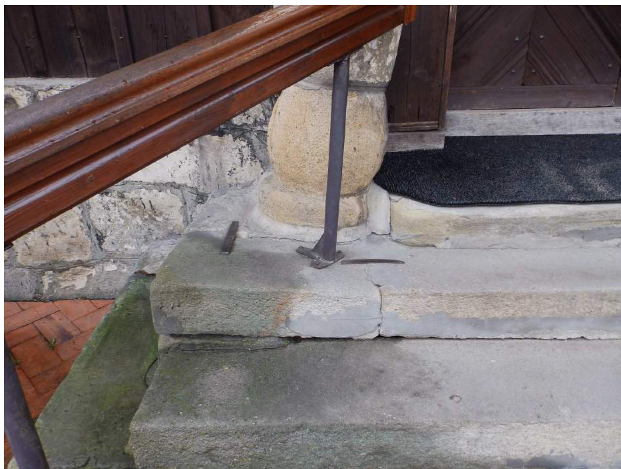
Fot.14 Pęknięty stopień blokowy i cementowe uzupełnienia
