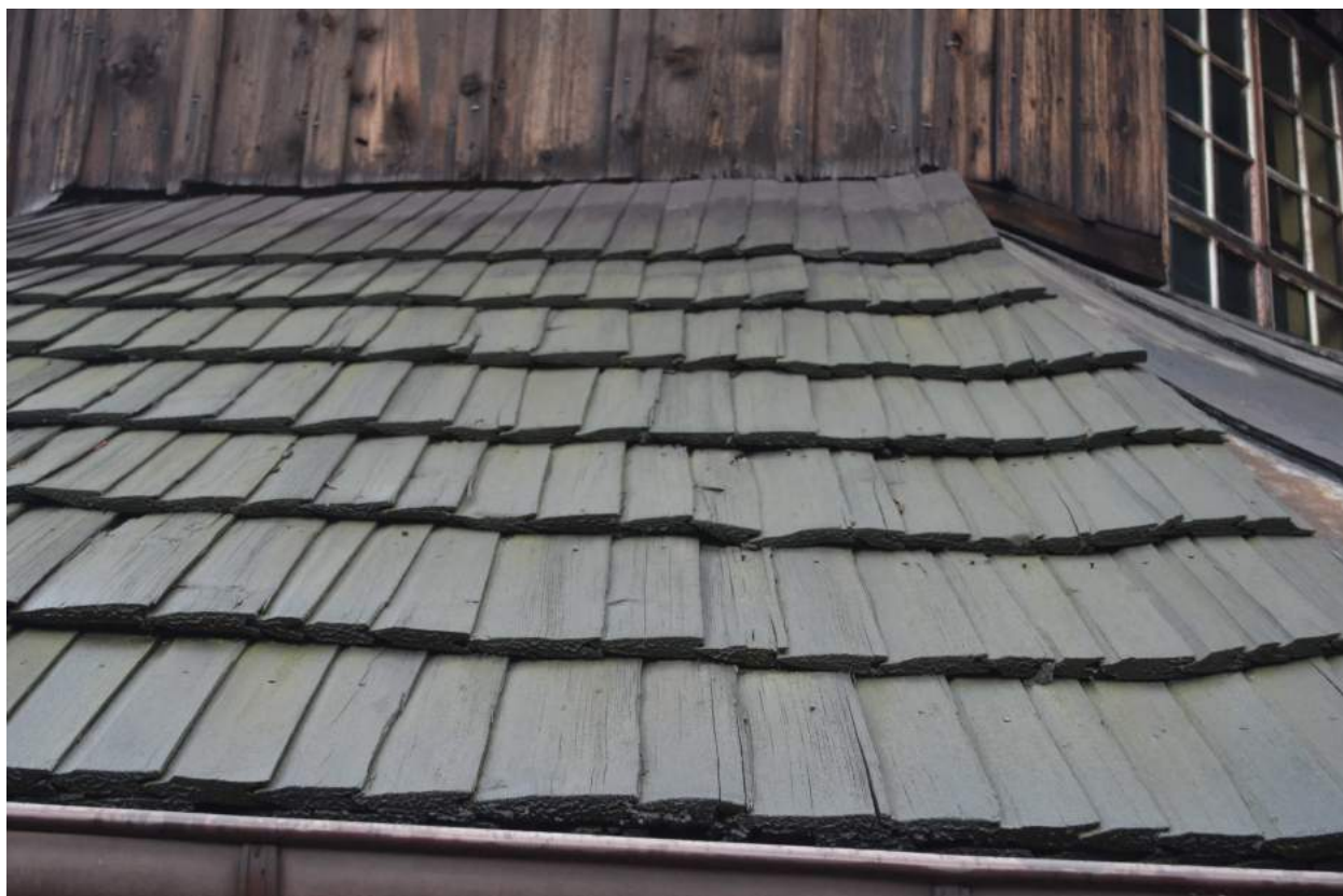
Fot. 5 – Korozja biologiczna gontów a sobotach
