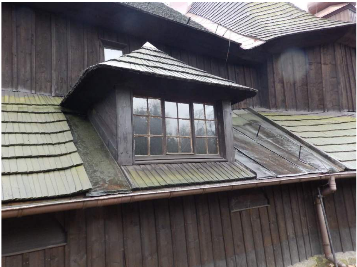
Fot. 3 – Obróbki blacharskie przy doświetleniu sobót
