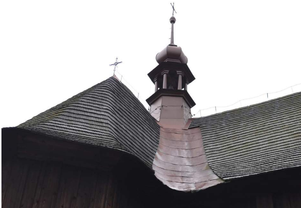
Fot.7 – Zdeformowana obróbka blacharska kosza
