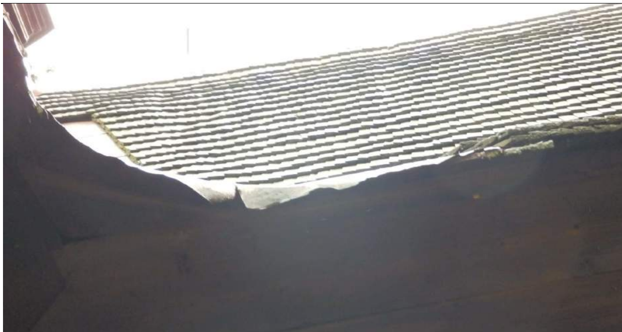
Fot. 11 Zniszczone obróbki przy okapie
