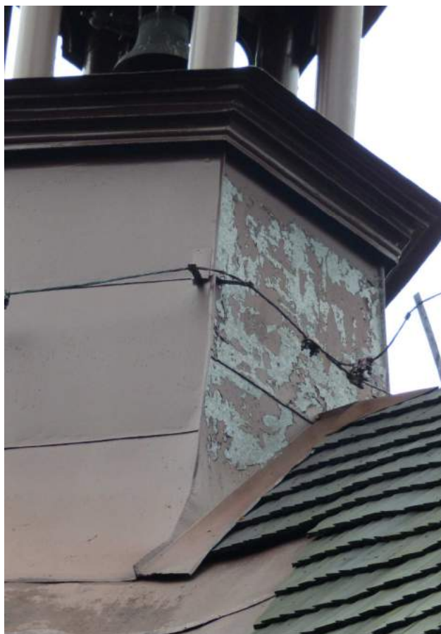
Fot.8 – Opłaszczowanie sygnatury i stan obróbek
