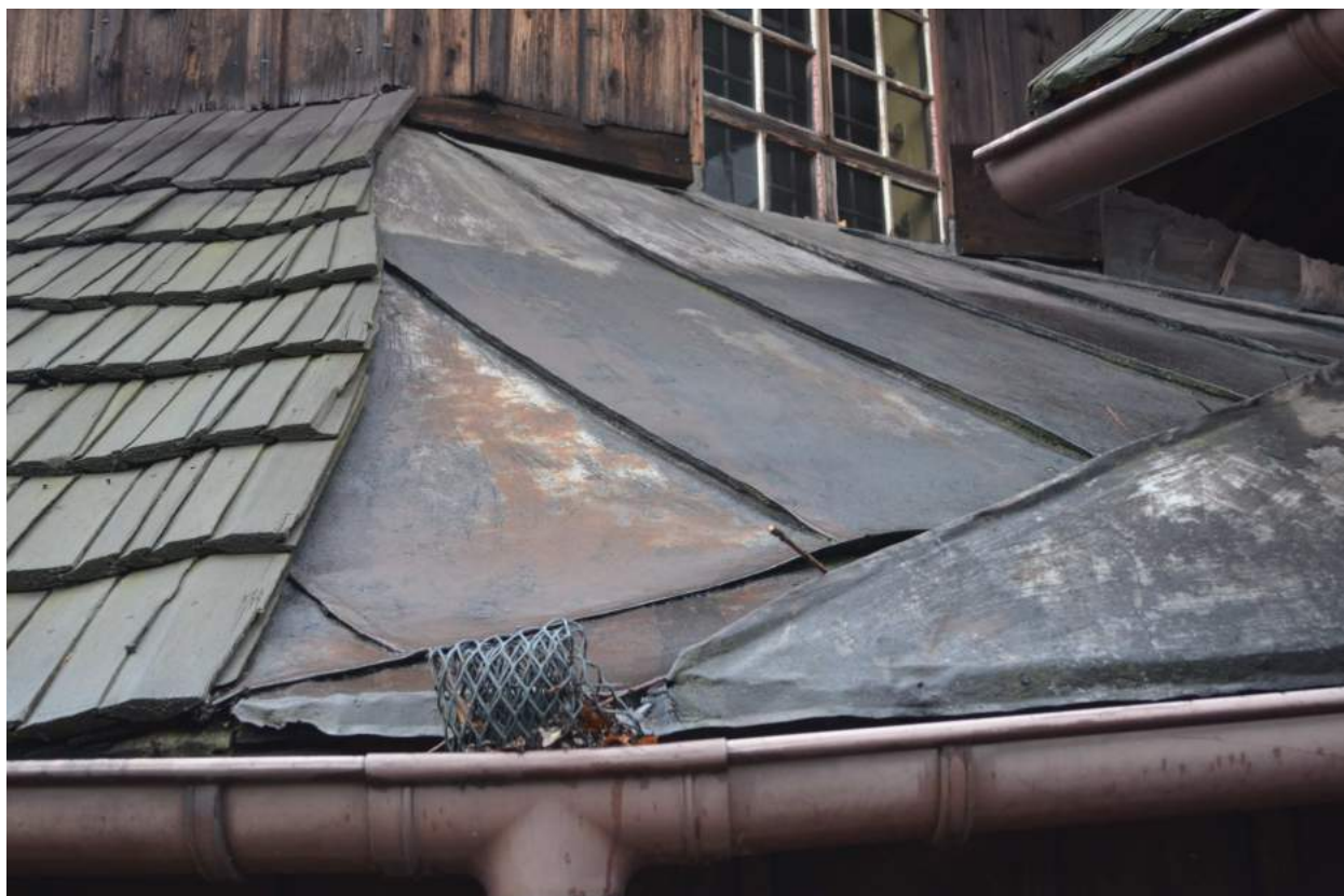
Fot. 4 – Obróbki blacharskie i gont po stronie północnej
