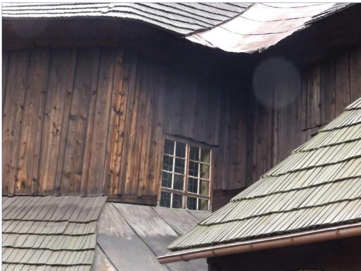
ogólny stan zachowania desek szalunku, - zróżnicowanie kolorystyczne spowodowane wypłukiwaniem przez wodę barwnika; zniszczenia blacharki i gontów; wyjałowione i zniszczone drewno stolarki okiennej - spękania i braki kitów szklarskich
